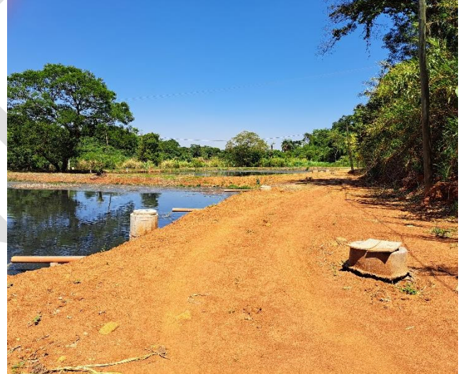
Poços de visita e tubos de entrada na lagoa da ETE Cidade
