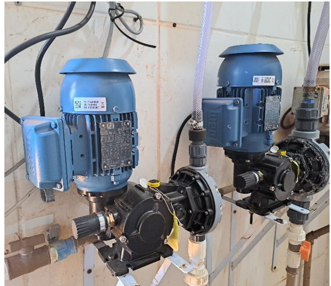
Duas novas bombas dosadoras (cloro e flúor) adquiridas e instaladas na ETA Central.
