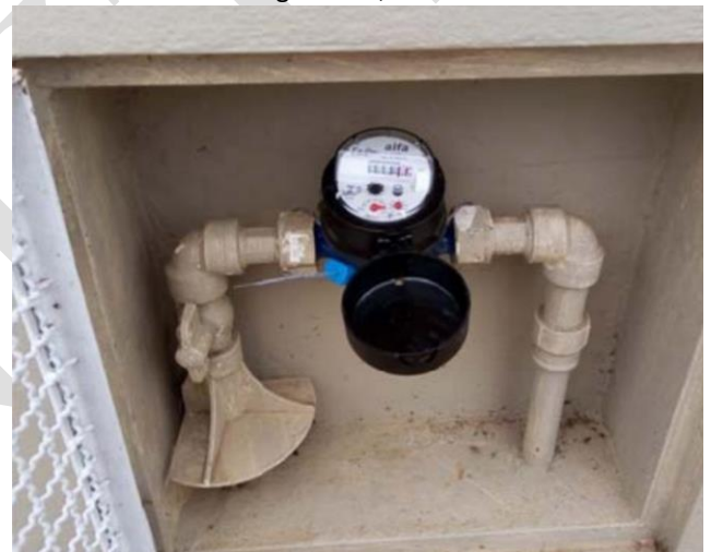
Novo hidrômetro instalado – Fonte: Thesis Engenharia, 2022
