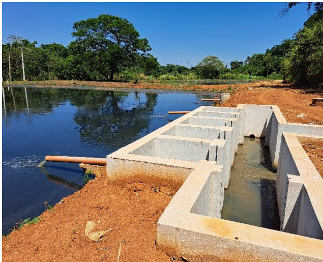
Caixa divisória e tubos de entrada na lagoa da ETE Cidade
