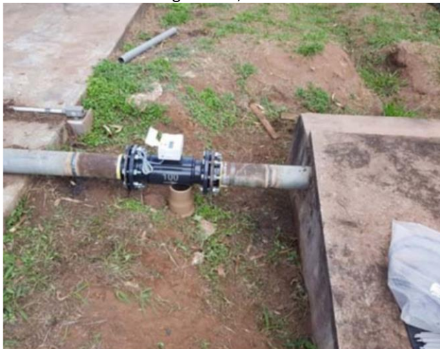
Vista do macromedidor 08 novo instalado – Fonte: Thesis Engenharia, 2022
