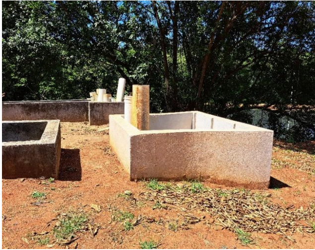
Caixa de distribuição pós tratamento preliminar da ETE Cidade
