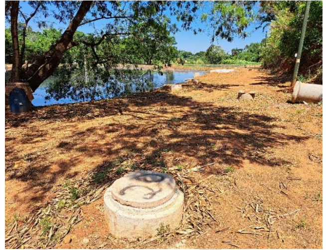
Poços de visita da ETE Cidade
