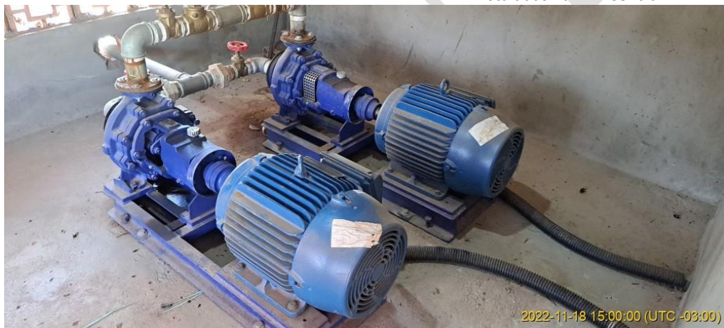
Dois novos conjuntos motobombas adquiridos e instalados na EEAT do Broa
