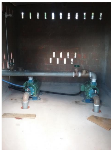
Figura 1 - Casa de bombas concluída e em funcionamento no Campos Eliseos
