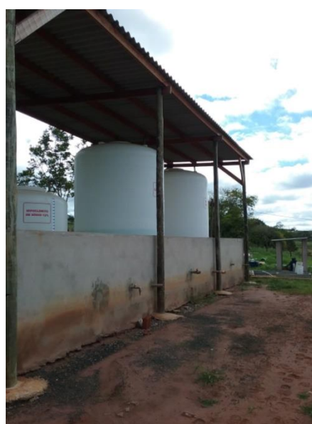
Figura 7 – Casa de armazenamento de produtos químicos na ETA
