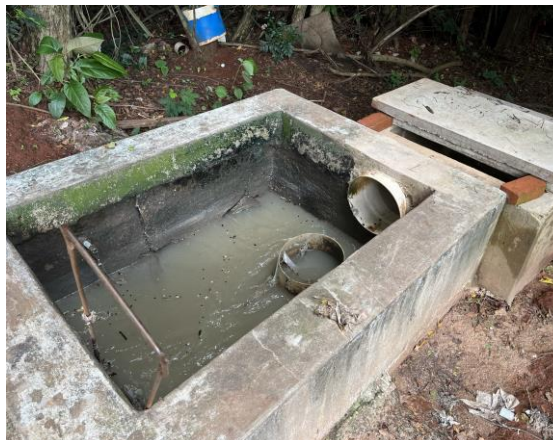
Figura 6. Vista da caixa de chegada do esgoto na ETE.
