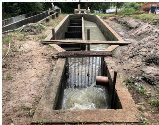
Figura 7. Vista do gradeamento e canais do tratamento preliminar.
