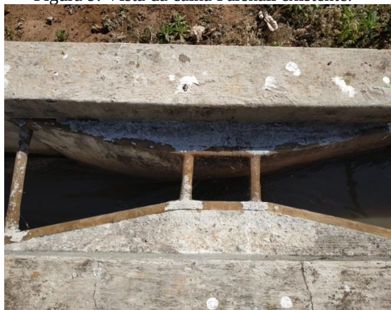
Figura 9. Vista da calha Parshall existente.
