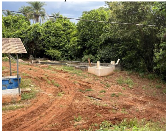
Figura 5. Vista geral do sistema de tratamento preliminar.
